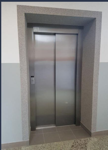
Winda dla niepełnosprawnych
